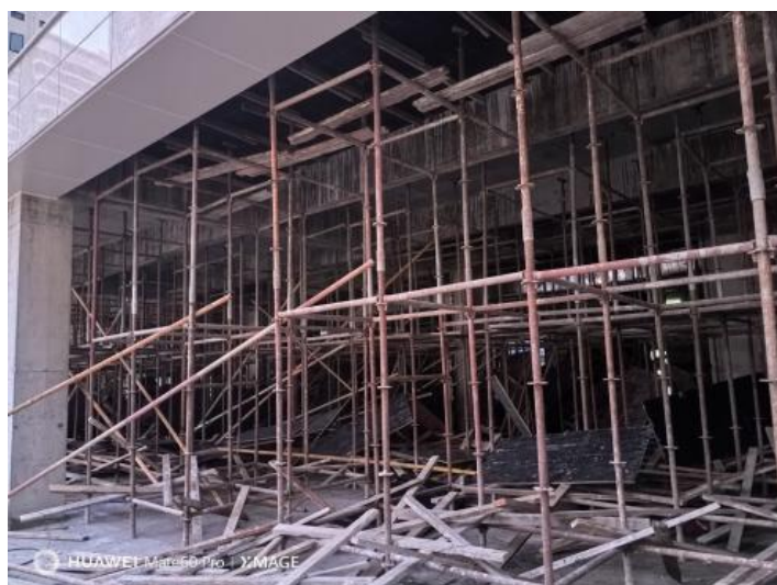
图6 位于11栋、10栋三楼楼面的事故现场外景
