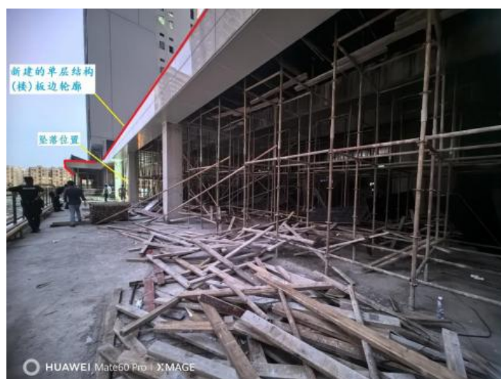
图5 位于11栋、10栋三楼楼面的事故现场外景
