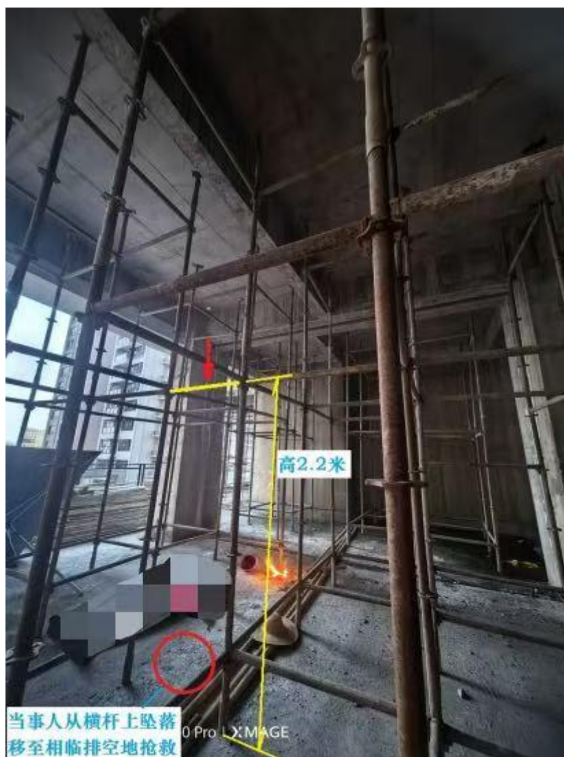
图 9 坠落点现场情况
